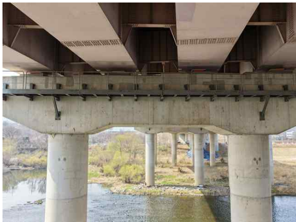
교각 P6 코핑부 상태현황
