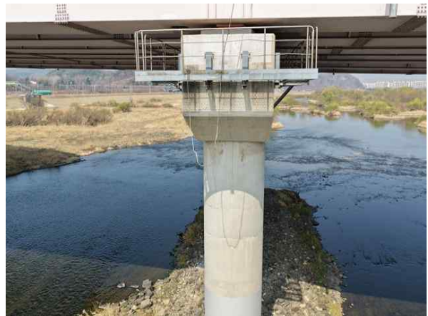
교각 P6 코핑부 상태현황
